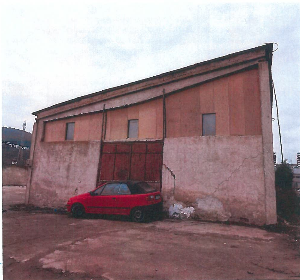
Fig. 38 – Perete exterior de fațadă – pericol de colaps
